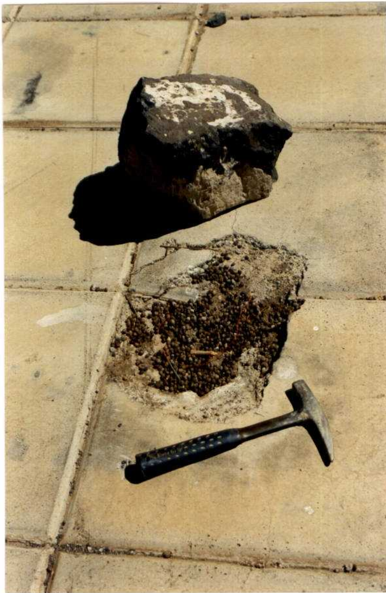
Fotografía nº 6: Detalle del impacto de un bloque grande sobre el pavimento.
