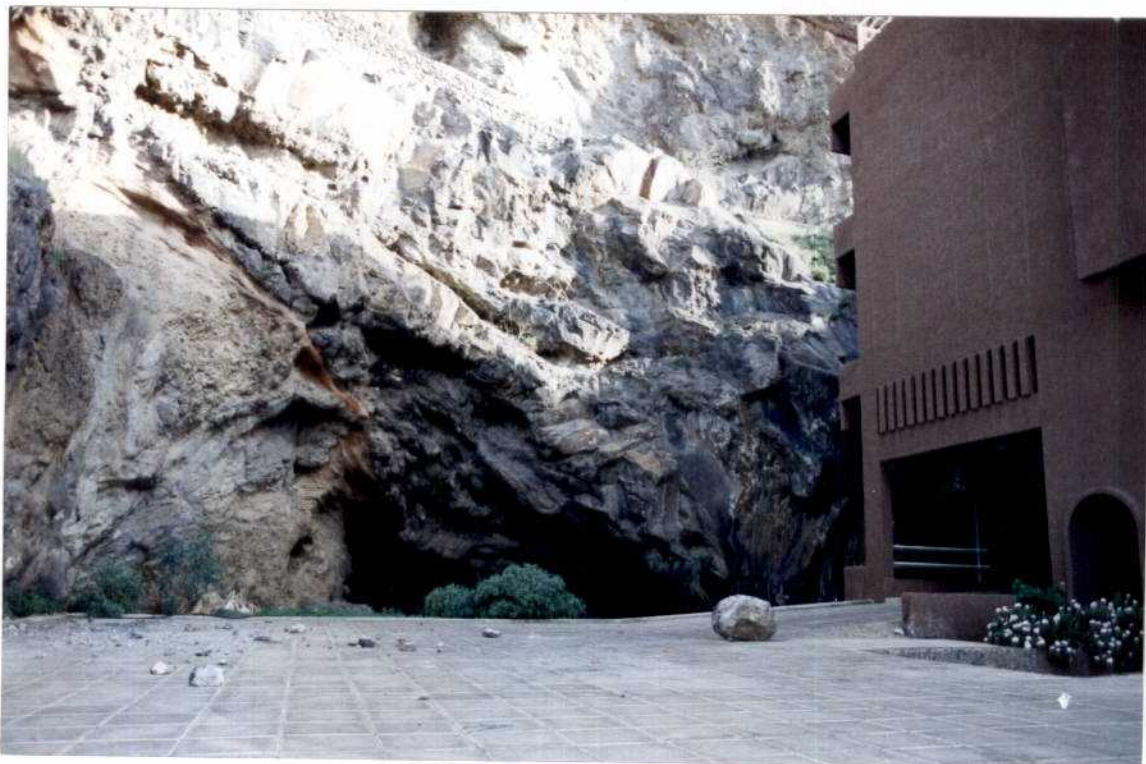
Fotografía nº 5: Bloques desprendidos en el aparcamiento
